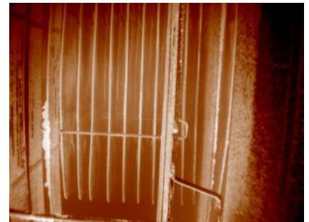
燃烧PRB煤的700MW电站锅炉内的过热挂钩
